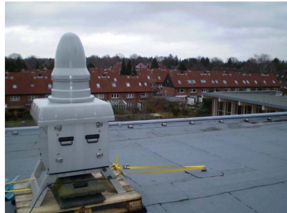
Der EMF-Monitor auf dem Dach der Albert Schweitzer Schule
